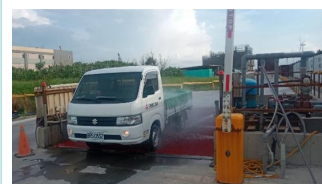
出入口設置洗車設備
